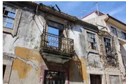
Figura 51: Casa de varanda «procissão» em mau estado, Mirandela.
