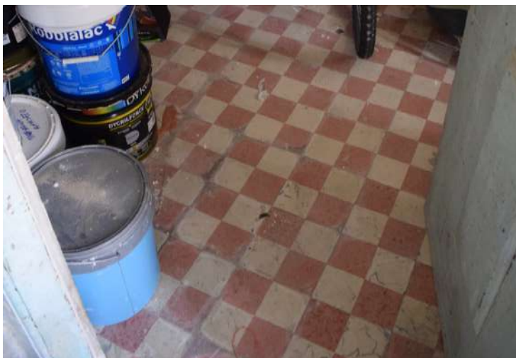
Figura 167. Chão entrada cozinha - Casa na Avenida General Moutinho, nº31 – 2019, Fotografia: Raquel Viveiros
