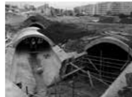
73N. Obras de canalização da ribeira de Alcântara na zona de Benfica, fotografia retirada em 1967 ©Camãra Municipal de Lisboa
